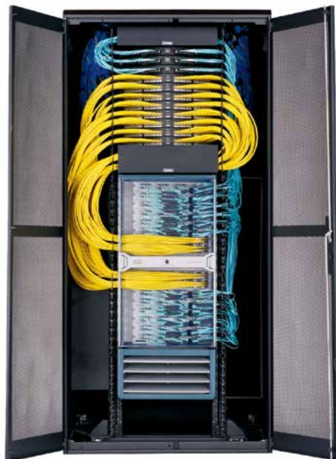
Шкаф Net-Access™ типа N с установленным модулем расширения Cisco^ Nexus 7018
